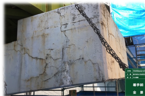
ASRによる劣化の様子
