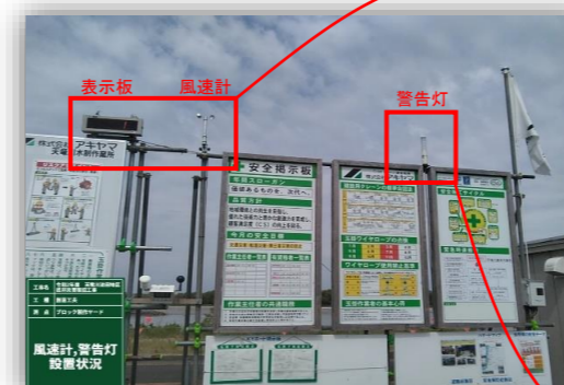
風速計・警告灯設置状況(安全掲示板)
