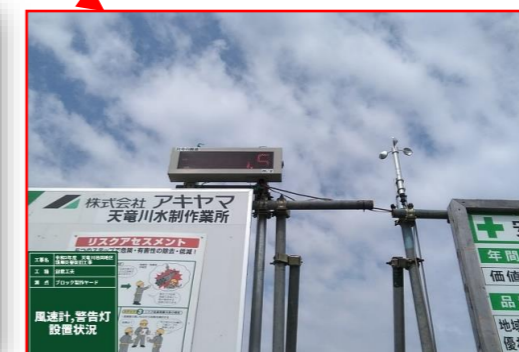
風速計・表示板設置状況(近景)
