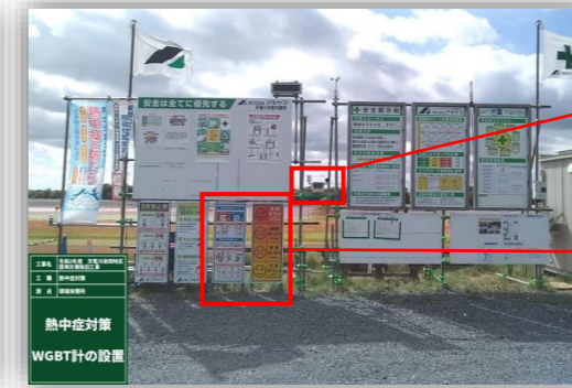
熱中症計設置状況(安全掲示板)
