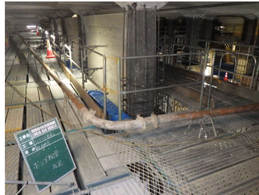
配水池内部の配管
