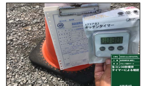
キッチンタイマー設置
