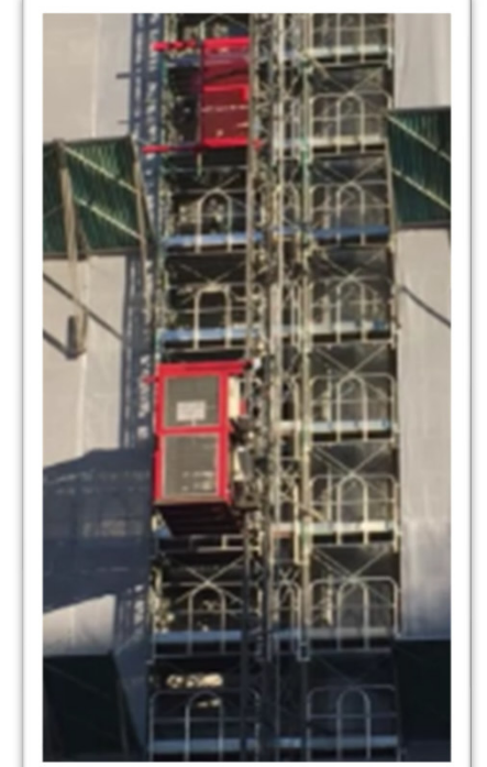
人荷用仮設EV
