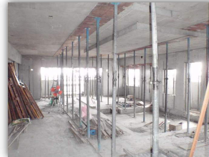
↑ 残存サポート状況
