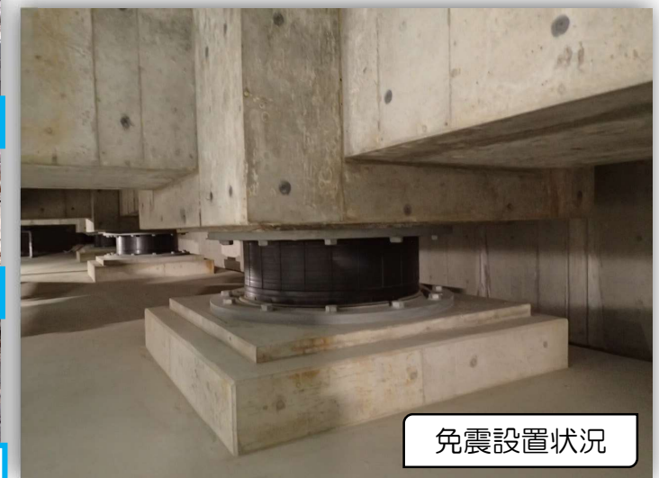
免震設置状況
