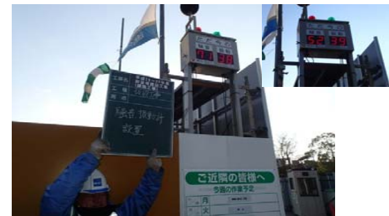
騒音振動計設置状況
