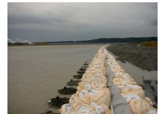
増水時の状況 (流出等の被害なし)
