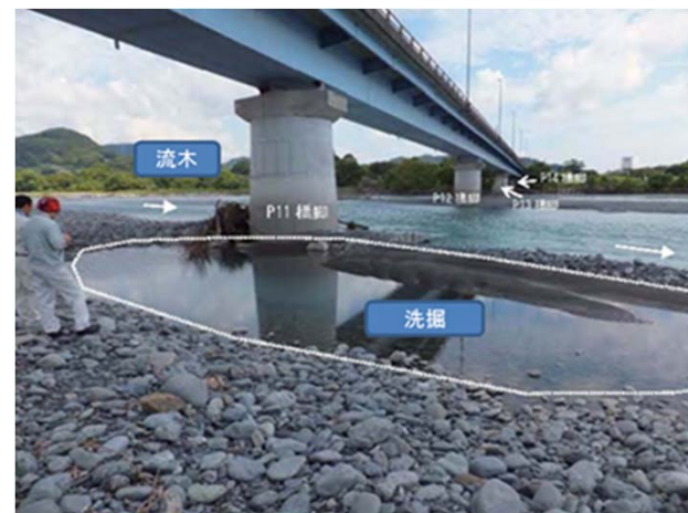
洗掘及び流木堆積状況
