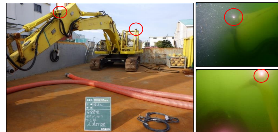
水中バックホウ運転席とブームへの点滅灯設置(左)と水中の点滅状況(右)
