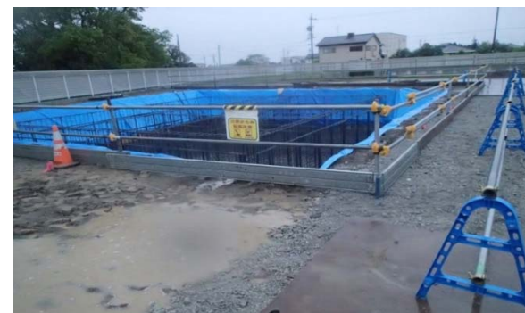
転落防止柵・安全通路
