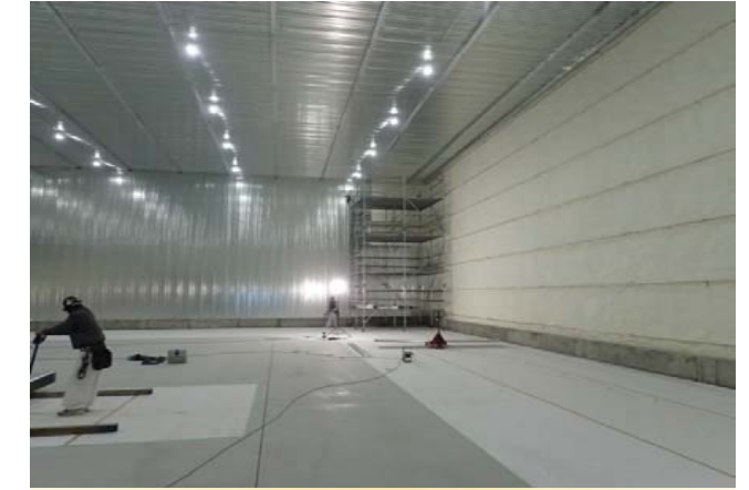
庫内壁防熱+キーストン
