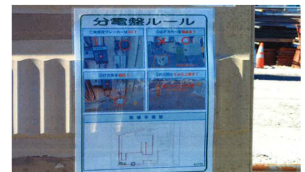
分電盤に写真によるルールの表示
