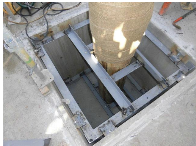
地下ピットに固定スペースを設け、鉄骨下地2段にて固定
