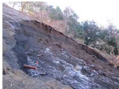
スコリア崩壊状況
