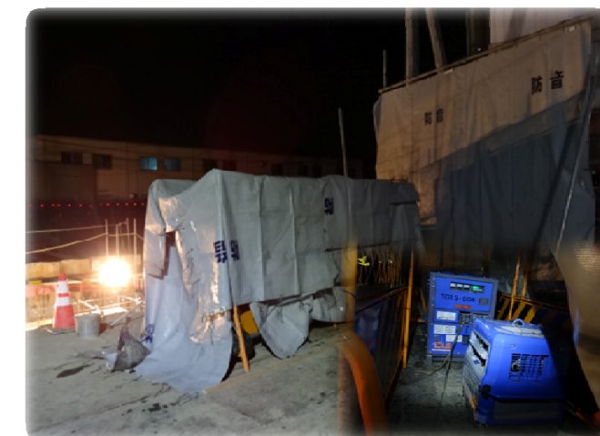
発電機防音対策写真
