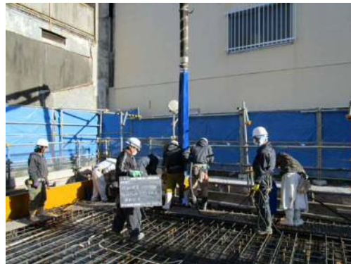
◀コンクリート打設状況（ライトウェイトコンクリートホース使用）
