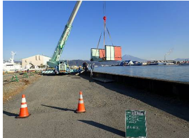
②(止水箱進水状況)
