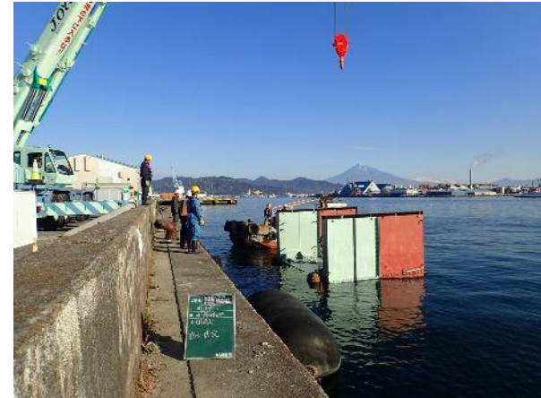
③(止水箱進水状況)
