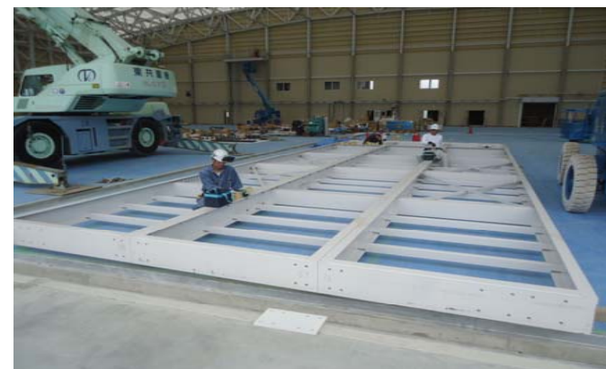
大扉鉄骨に地組み ※コンクリート強度発現を確認し揚重機を土間に載せる。
